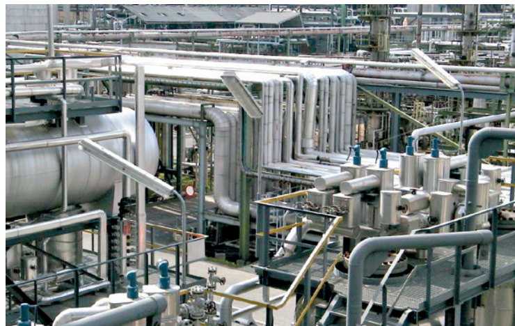
Rohrleitungen (TÜV AUSTRIA)
